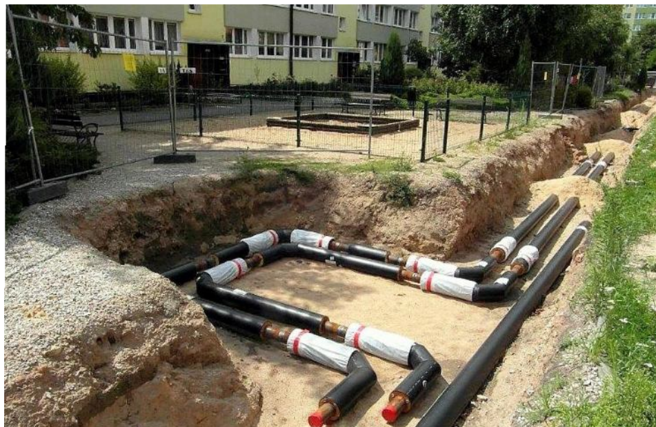
Sieć kanałowa zastępowana jest siecią z rur preizolowanych
