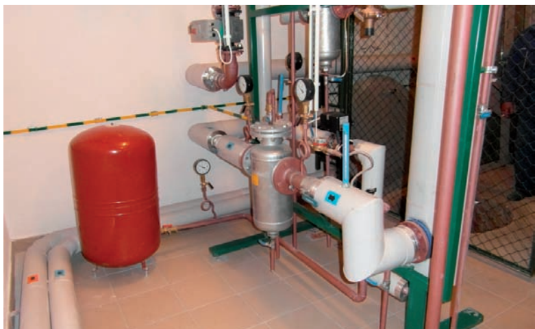
Węzeł ciepłowniczy w obiekcie użyteczności publicznej - po remoncie
