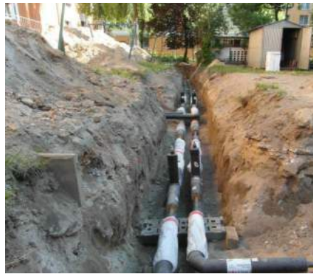
Modernizacja sieci przy ul. Energetyka 1, 3, Górnicy 2, 4, 6 i al. 1 Maja 12, 14 pozwoliła na likwidację grupowego węzła ciepłowniczego przy ul. Kotłowej 1
