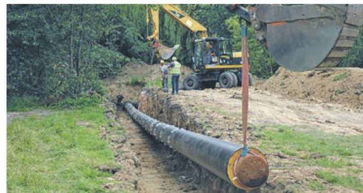
W wydrążone otwory, pod drogą krajową nr 92, zostały wprowadzone dwie 60-metrowe rury ciepłownicze
