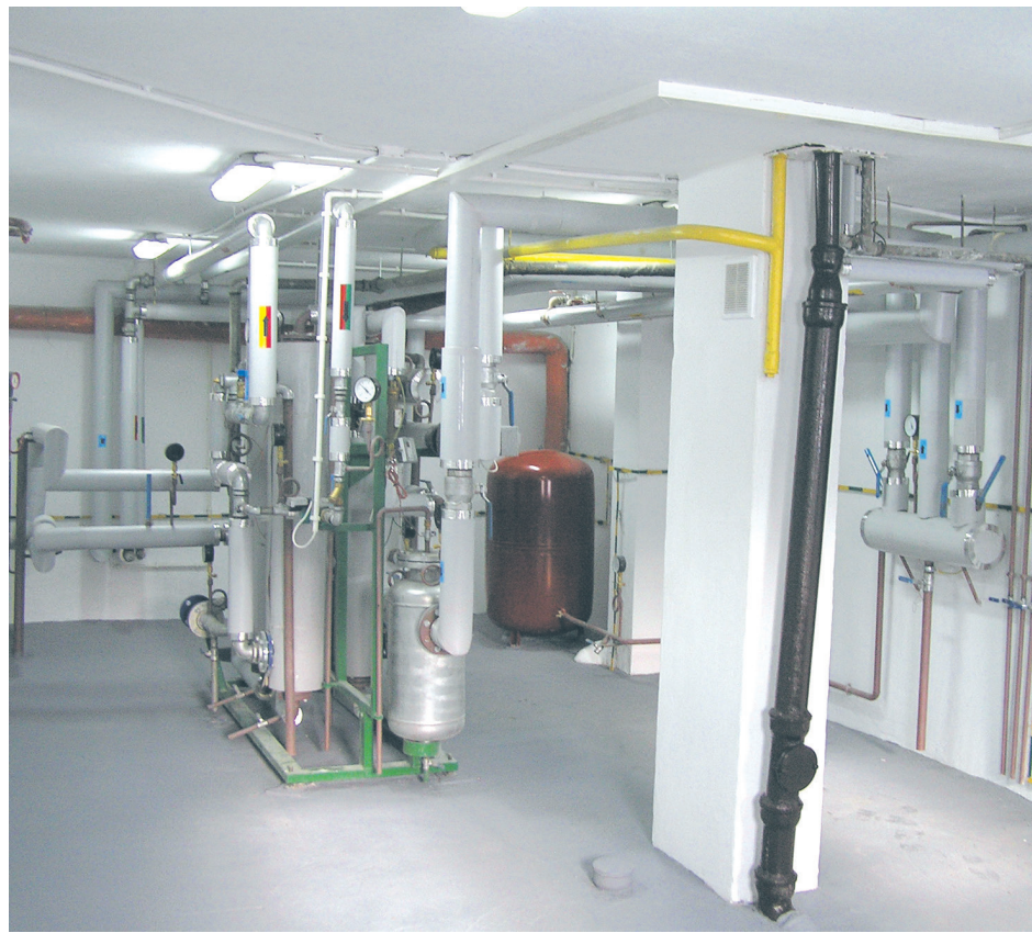
Nowoczesny węzeł indywidualny
